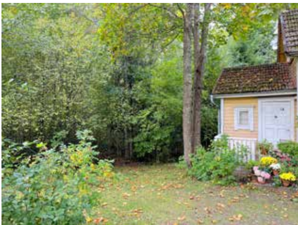
104. Aattolan eteläpuoleinen piha on hyvin varjoisa. Nurmikko on sammaleinen, ja myös talon eteläosan betonitiilikatto on sammalen peittämä. Aivan eteläpäädyn vieressä kasvava suuri, monihaaraainen vaahtera olisi syytä poistaa, jotta rakennuksen hoito ja säilyttäminen olisi helpompaa.
